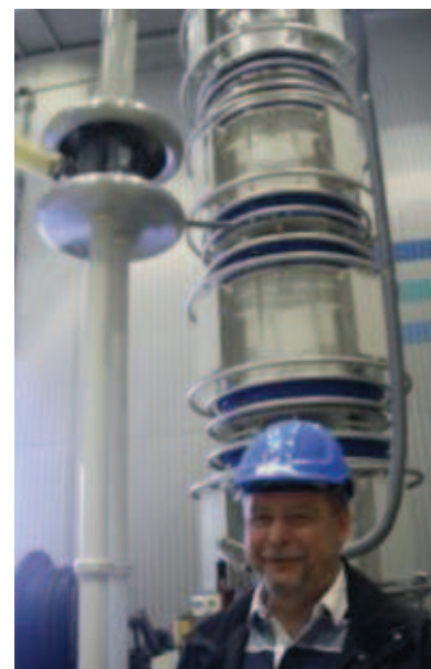
TESTER LANGT: Testtransformator for prøving av lange kabler, opp til ca. 30 km. Ytelse: opp til 600kV / 240A AC. – Vi har også utstyr for testing av lengre lengder sier avdelingsleder Erik Sandtangen. FOTO: MONA SPRENGER
